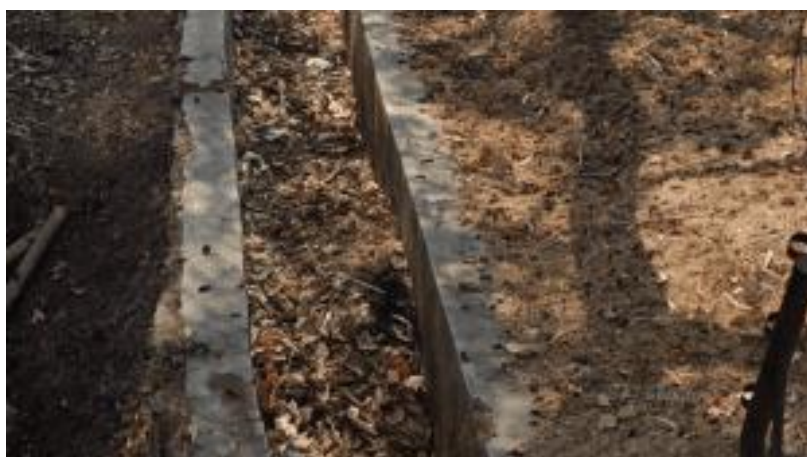
Gambar 11. Saluran Drainase Depan Tapak
