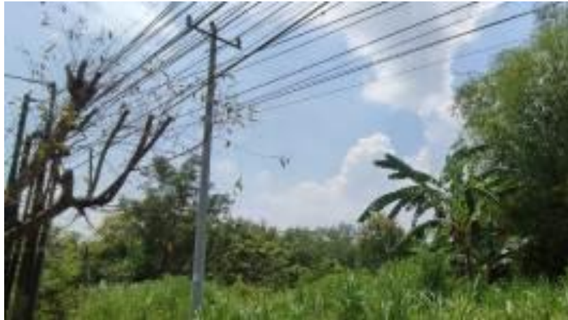
Gambar 8. Jaringan Listrik di Tapak Sumber Gambar: Dokumentasi Pribadi, 2025
